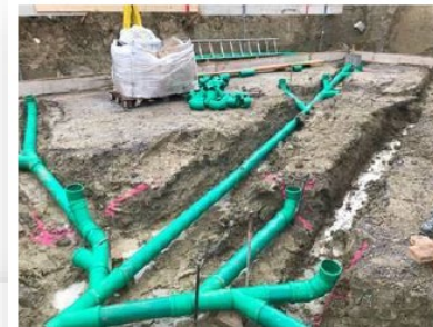
Mehrere Abzweiger als Beispiel bei der Liegenschaftsentwässerung
